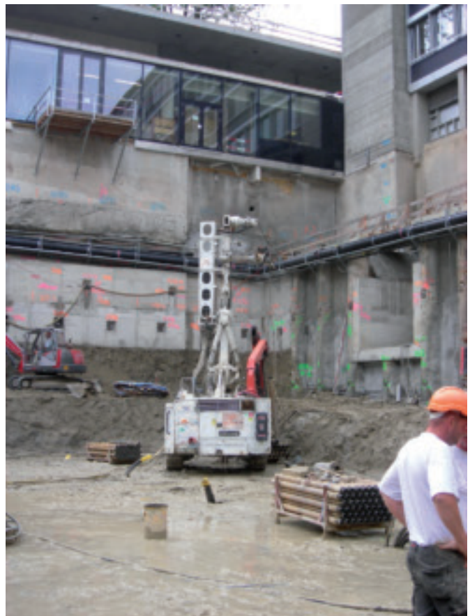
Baugrube Baustelle ETH HPL Life Science Platform Zürich mit angrenzenden, bereits bestehenden Gebäuden
