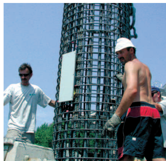
Abb. 7 ■ Lagegenauer Einbau eines Bewehrungskorbes mit Ausrichtung des Anschlusskastens für einen Energiepfahl \varnothing 1200.
