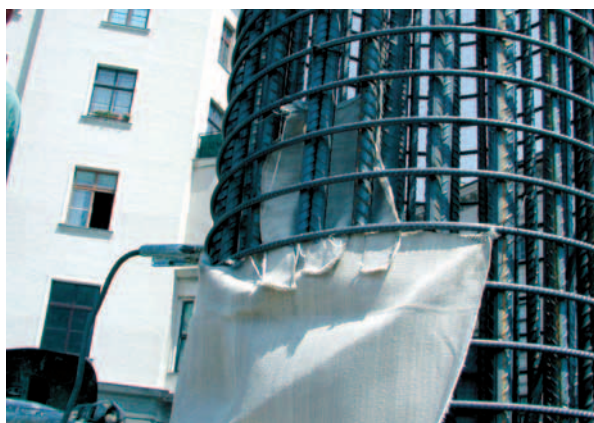
Abb. 6 ■ Verbindung der Bewehrungskorbhälften eines Energiepfahls \varnothing 1200 mit Schweißschutzmatten zum Schutz der HDPE-Rohre.
