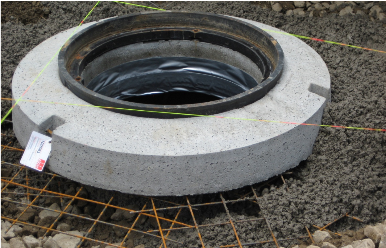
Bild 6: Einsatz von umlaufender Armierung mit Netzen oder Eisen im Verbund unterhalb des Betonkranzes ca. 0.5m bis 1m Radius.
