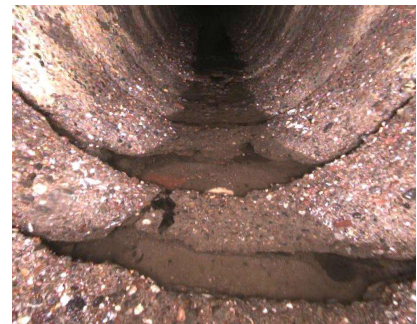
Biegesteifes Rohr durchge- brochen
