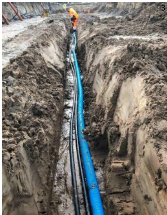
Illustration 3: Sonde GEROtherm® à côté de la conduite d'eaux usées Photo: www.termonet.dk
